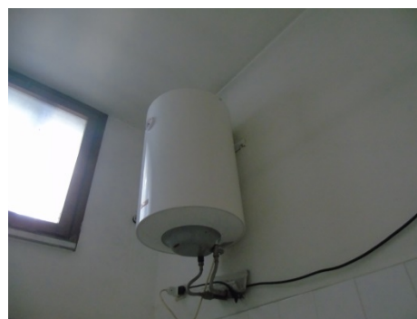
Figura 4.12 - Particolare di un boiler elettrico per la produzione di acqua calda sanitaria
