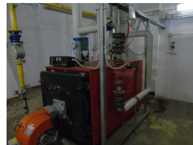
Figura 8.3 – Sistema di generazione obsoleto da sostituire
